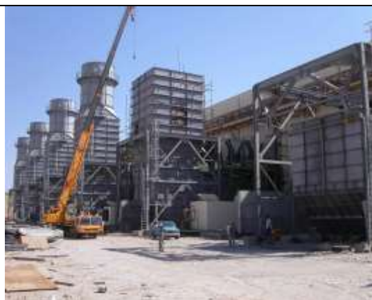
تجهیزات نیروگاههای گازی
