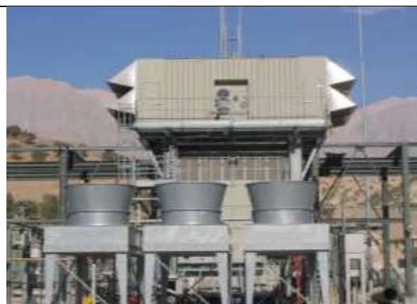
تجهیزات جانبی توربو کمپرسور خطوط انتقال گاز
